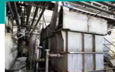
D 加圧浮上装置
