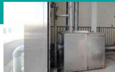
G 水質監視槽/放流槽
