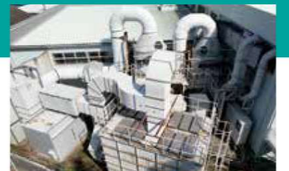
K 脱臭装置
