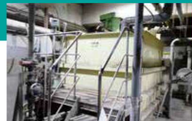
J 中和設備/油水分離装置
