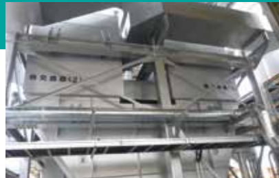
熱交換器 二次燃焼炉の排ガスを冷却すると共に、発生する加熱空気を煙突に送り白煙対策を講じています。
