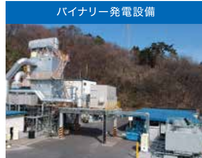
バイナリー発電設備
