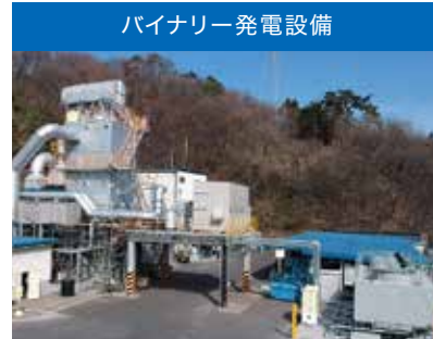
バイナリー発電設備
