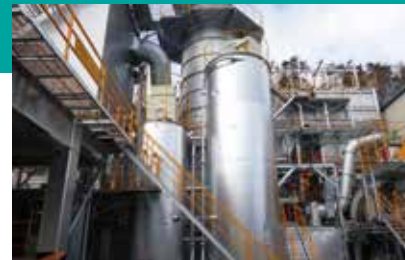
消石灰サイロ・活性炭サイロ 消石灰、活性炭を使用することにより、排ガス中の酸性ガス(HCL,SOx)、ダイオキシン類及び重金属の吸着除去を行います。
