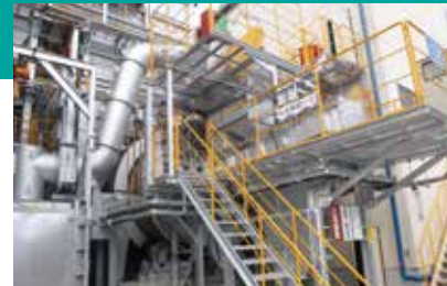
ロータリーキルン 油泥、汚泥、廃棄塗料粕等を焼却します。
