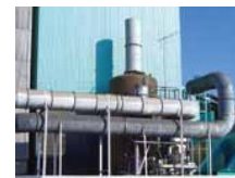
L ガス洗浄装置
