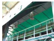
J 脱臭ダクト
