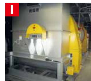
I スラッジドライヤー
